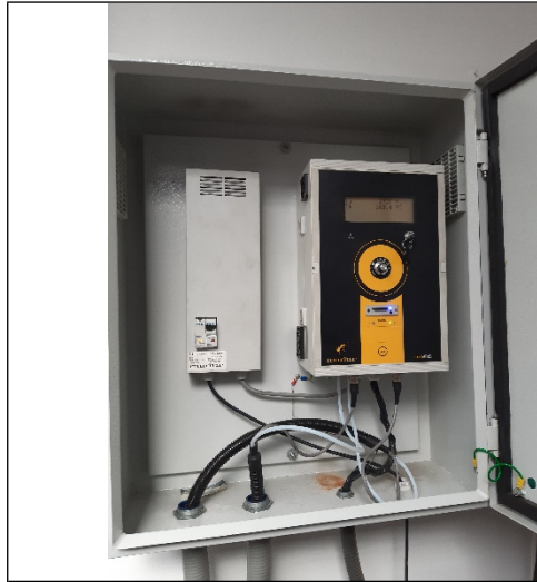
Foto No. 5 Sistema de monitoreo continuo
